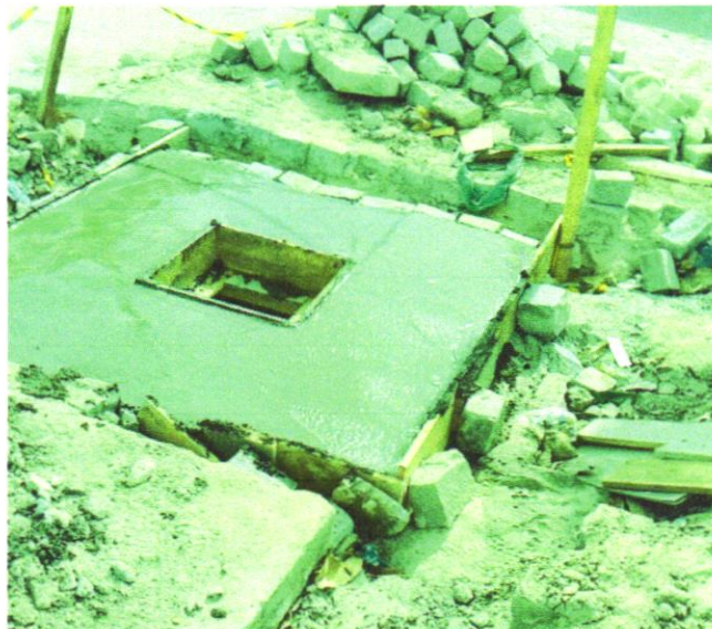
Foto 02 –TAMPA DE CONCRETO PARA CAIXAS DE PASSAGEM 0,80X0,80MX0,07M
